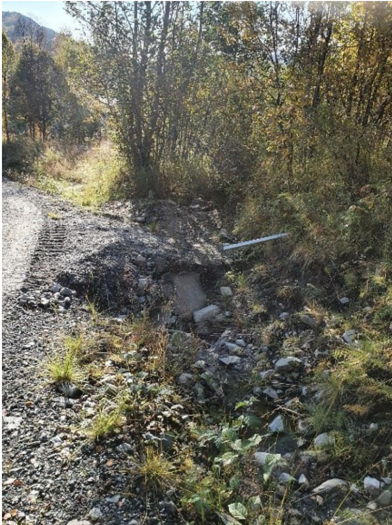
Figur 5. Statnett har foretatt grøfterensk og byttet ut stikkrenner for å lede vekk overvann fra veien. Foto: NVE
