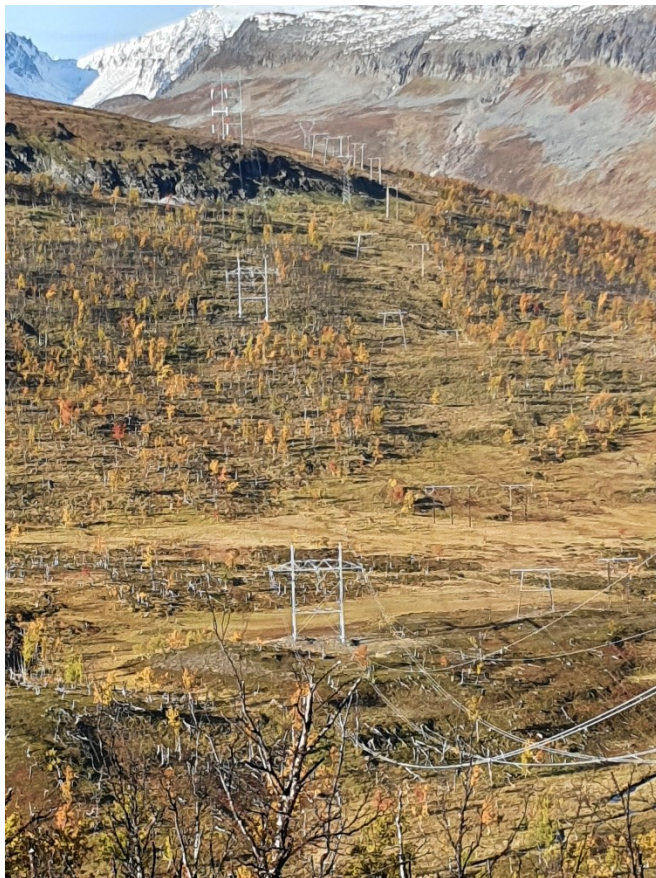
Figur 21. Ledningen (t.v) sett sørover fra BM493. God fjernvirkning av ledningen. Høyere master og linjeføring gjør at det kan stå igjen mer vegetasjon under ledningen. Navitdalen i bakgrunnen. Foto: NVE
