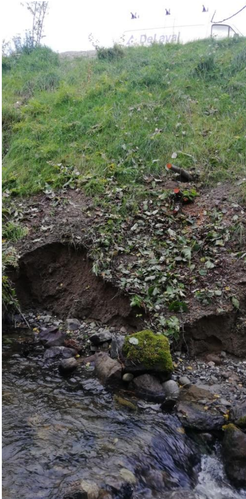
Figur 7: Litt erosjon (score 1) like nedenfor garasje, nord for bekk. Foto: Raymond Nilsen.
