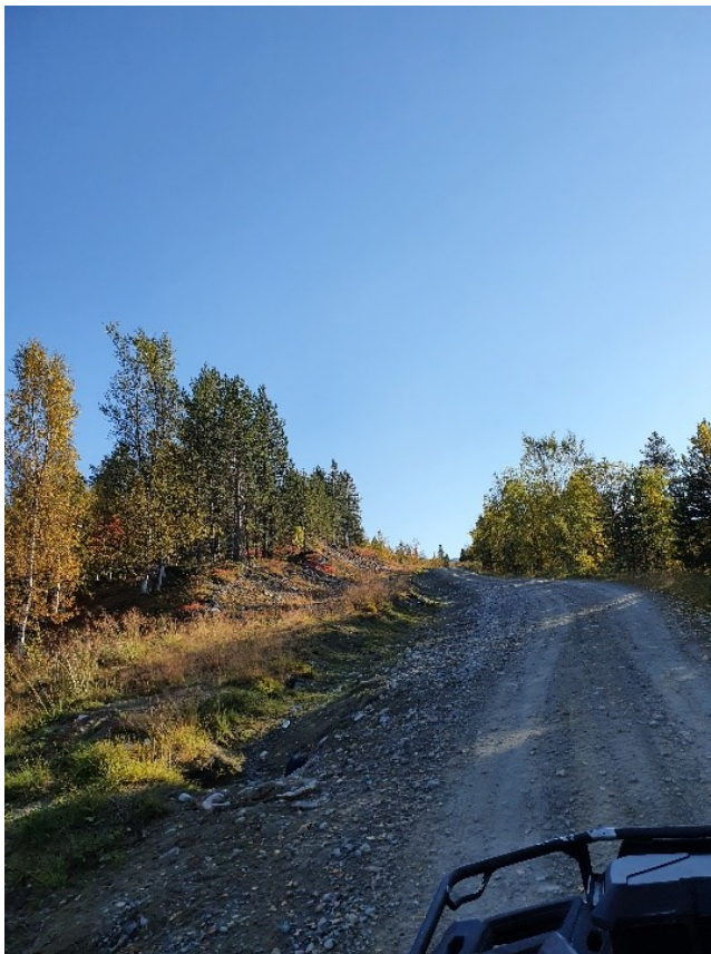
Figur 15. Veien opp til Gahperus ble utvidet under anleggsarbeidet pga. sikkerhet for personell og allmennheten. Veien er tilbakeført til opprinnelig bredde og vegetasjonen er på vei tilbake. Foto: NVE
