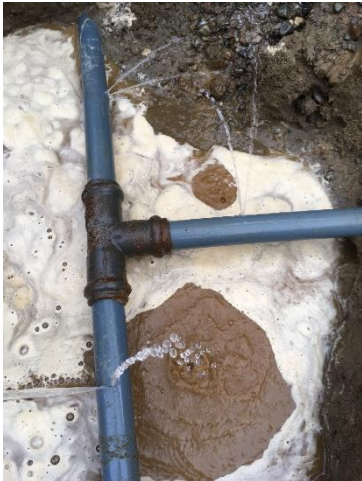
Dobbel vannlekkasje avdekket.
