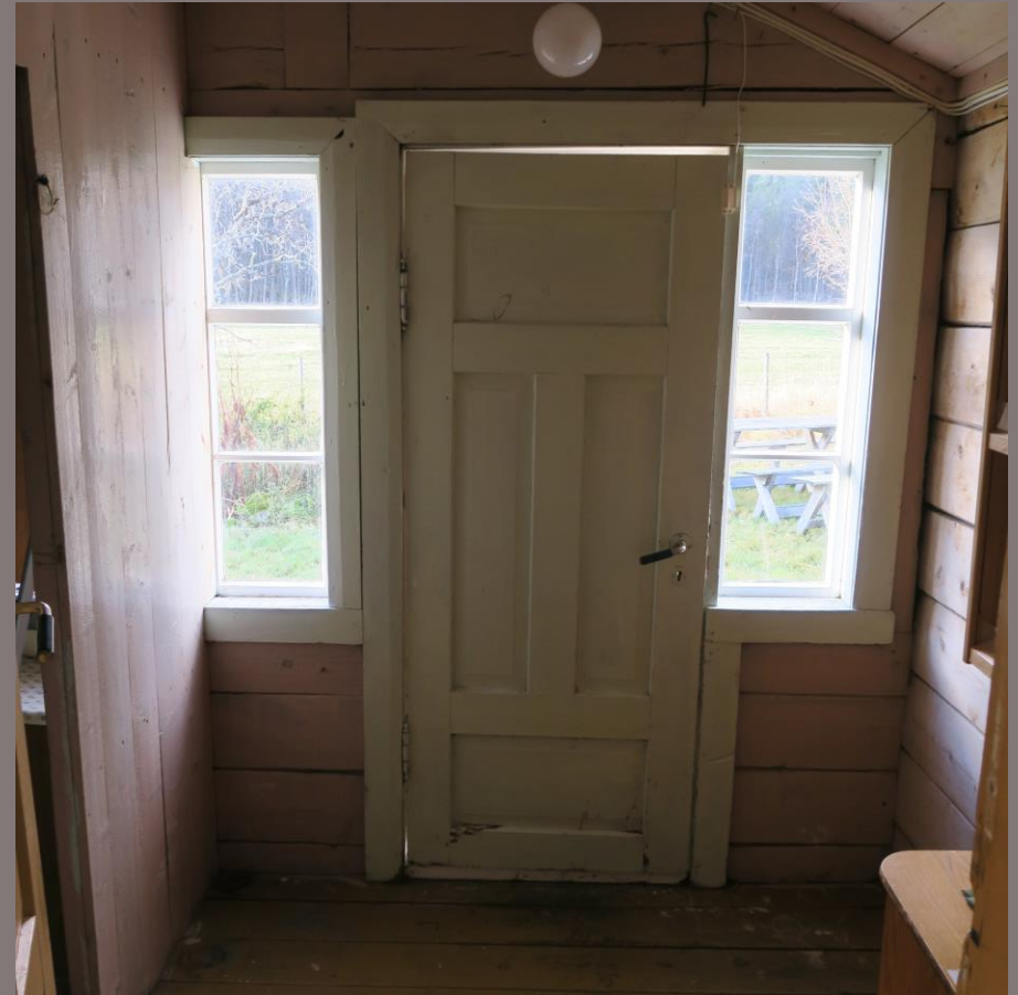
Godt gjennomlys med vinduer på begge sider av inngangsdør. Lik løsning for dører med vinduer ut til balkongene i 2.etg
