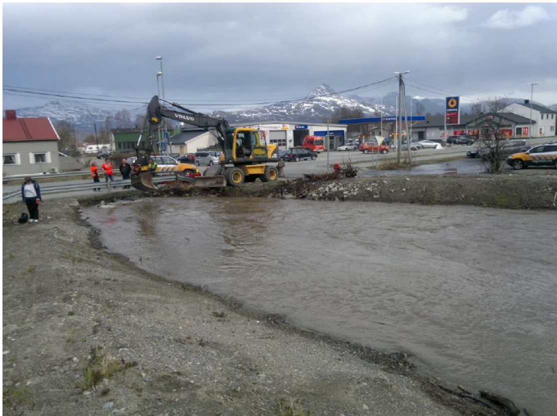
Figur 13: Flom i Jernelva ved E6 krysningen mai 2012 med daværende bro og utarbeidet flomtiltak. Foto: NVE.
