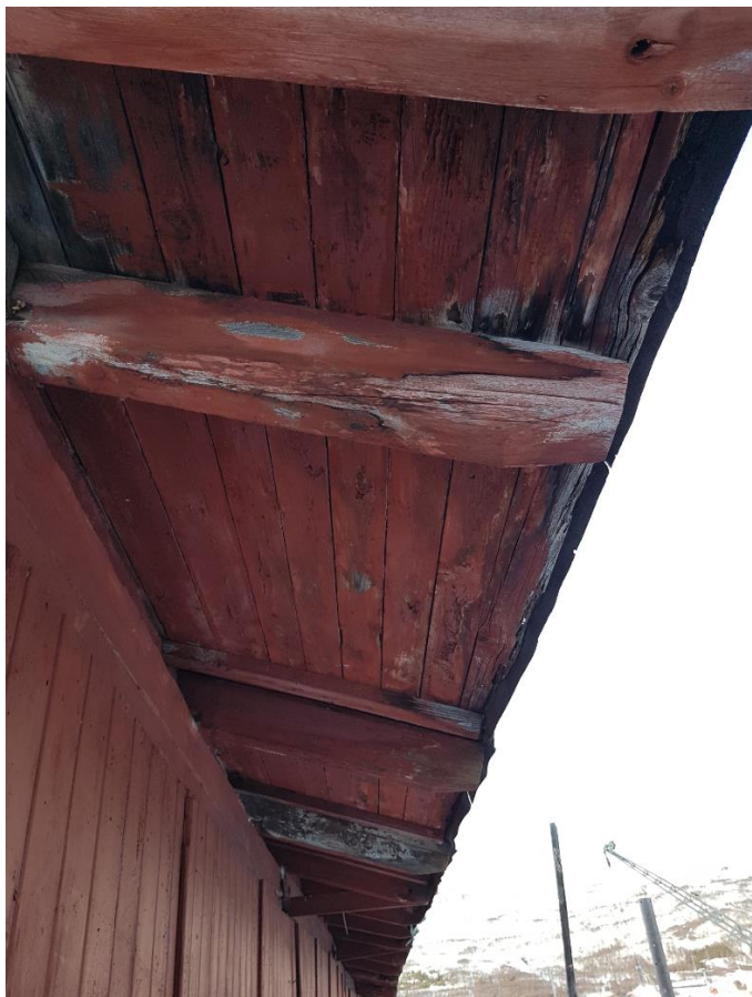
Takstolene og undertaket på nordsiden bærer preg av slitasje.
