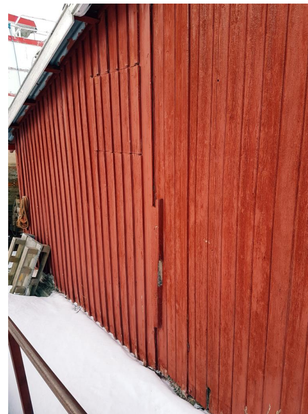
Stående panel på baksiden, gavlsiden, har to forskjellige karakter. Opprinnelig panel er låvepanel. Påbygget er bygd i tømmermannspanel.
