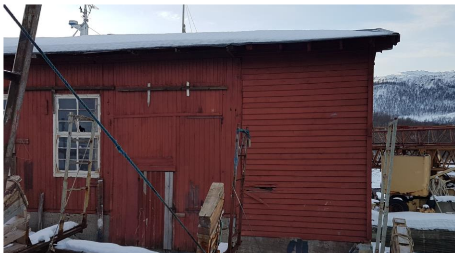
Utvidelsen er synlig på fasaden. Den opprinnelige delen av bygget og påbygget har to ulike paneltyper. Både bredde og retning på panelene påviser utvidelse fra 1950-tallet.
