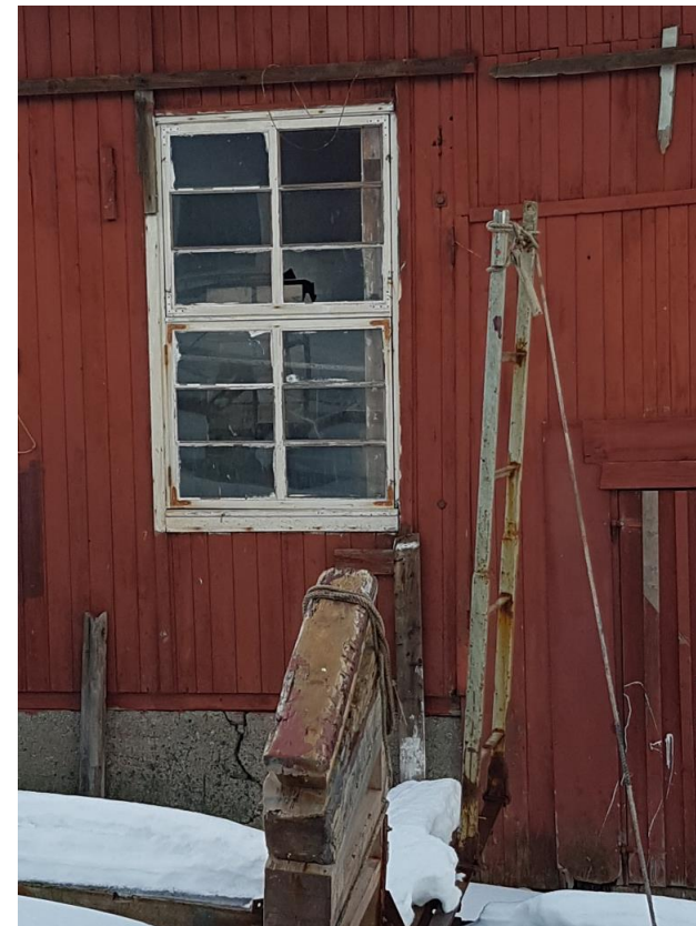
Vinduene og fasaden er i dårlig forfatning.
