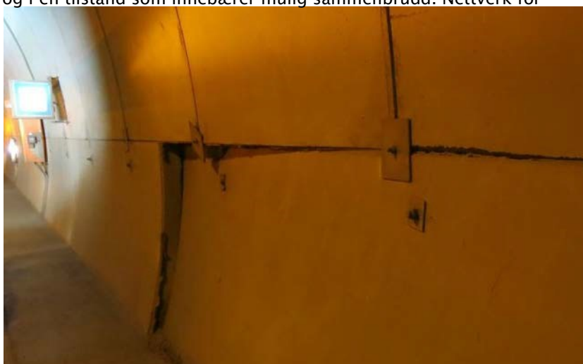
Skade i tunnelvegg (Breivikatunnelen). Foto: SVV
