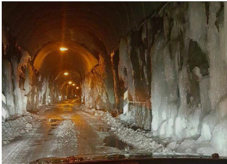
FARLIG: Manglende isolasjon fører til at Flordgårdtunnelen- og Ømfjord-tunnelen er lekk. På vinterstid fører det til store problemer med is.
