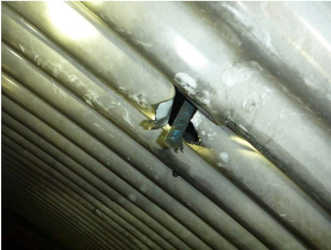
Vibrasjoner i hvelvet fører til at opphengsbolter presses gjennom
