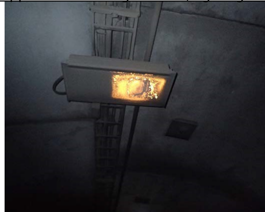
Dårlig tunnelbelysning, ikke renoverbar Foto: SVV
