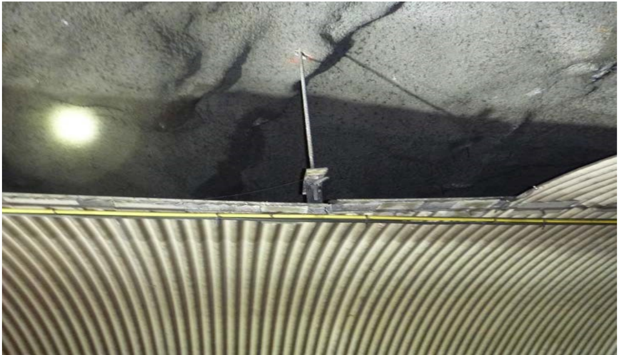
Plater med innfestning løsner, flere har falt ned i kjørebanelen
