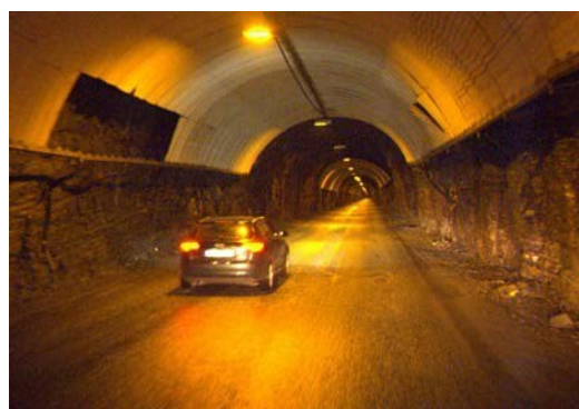
Bærende takelement Maursundtunnelen. Foto: SVV
