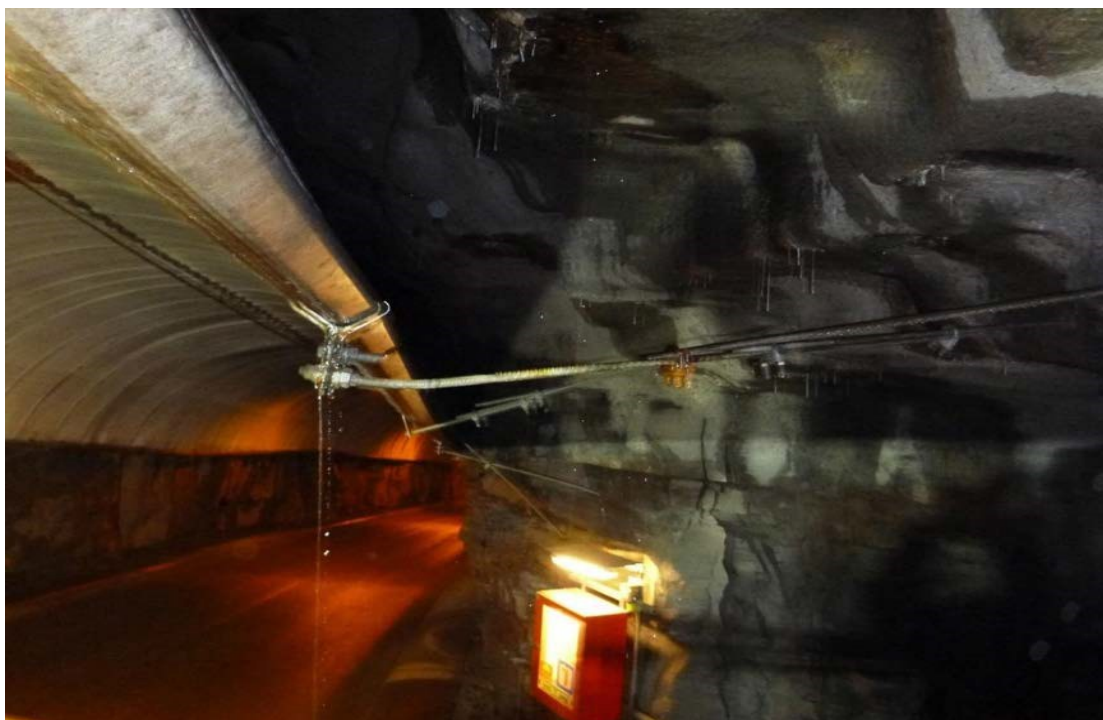
Store lekkasjer i konstruksjon, foto viser nødreparasjon av innfestning.
