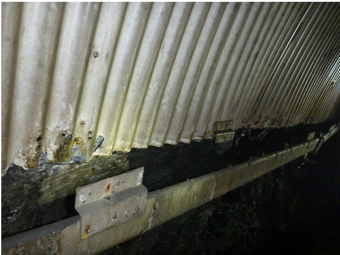
Plate løsnet på grunn av vibrasjoner og lufttrykk fra tungtrafikk
