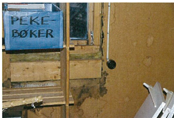
Vannskade rundt vindu på loft
