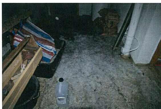
Is på gulv i vaskerom i kjeller
